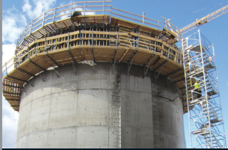
Tartu Biogas Plant, Estonia
